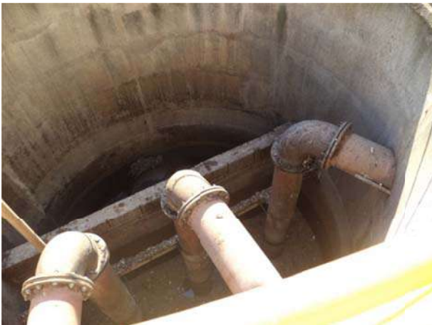
Figura 25 – Elevatória de esgoto bruto
