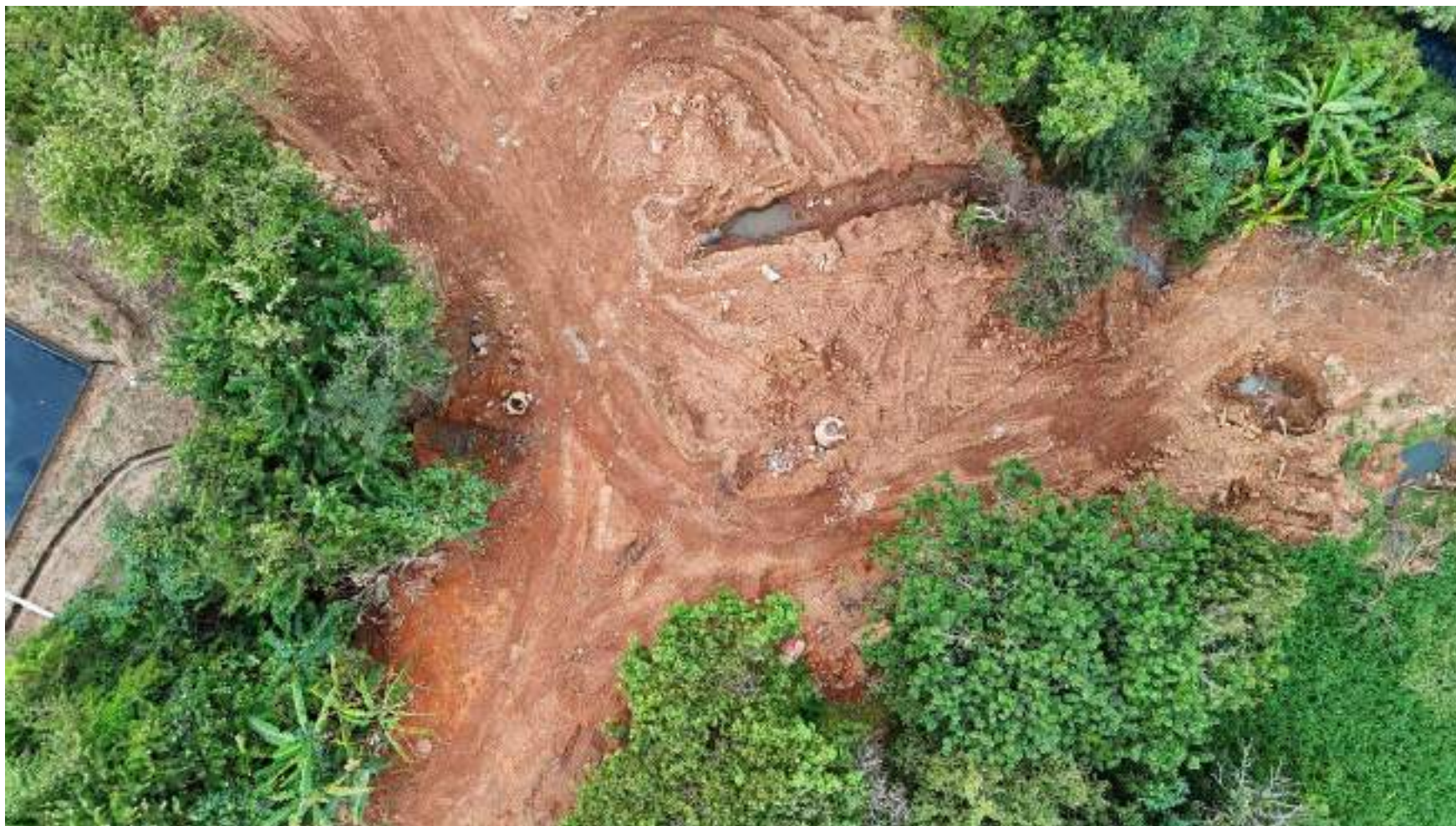
Foto 07 — Vista do corredor de intervenção — detalhe da vala escavada, solo movimentado e pontos de extravasamento de esgoto ao longo do traçado.
