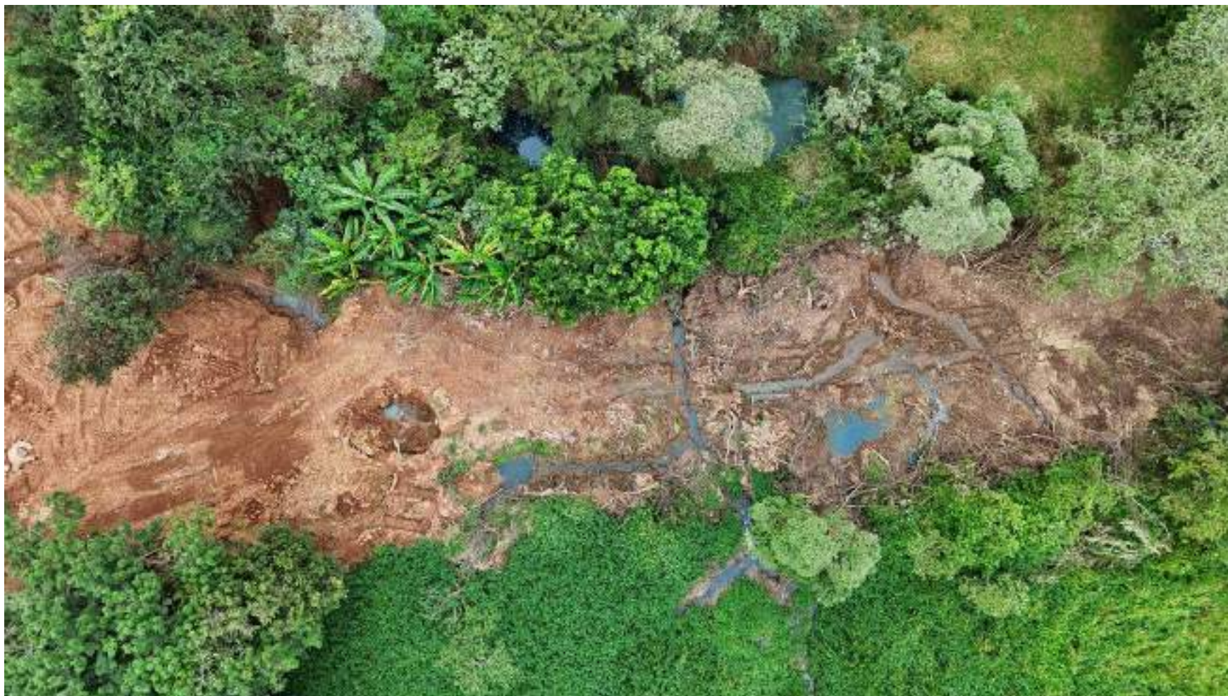
Foto 15 — Trecho final do emissário existente — detalhe dos pontos de extravasamento próximos ao PV de interligação à EE São Domingos.
