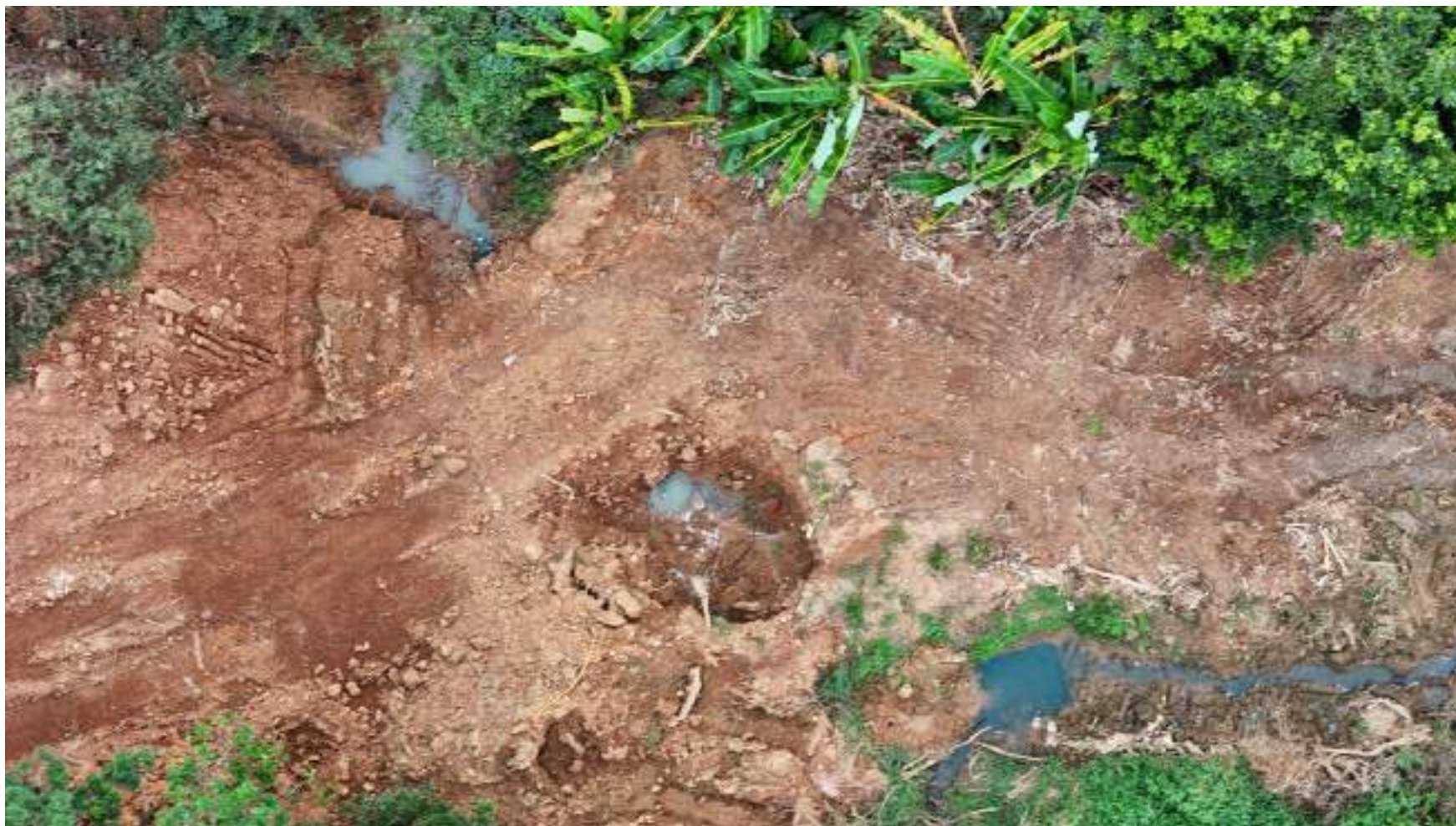
Foto 24 — Vista complementar — detalhe das condições finais do trecho, evidenciando a extensão total da intervenção necessária.
