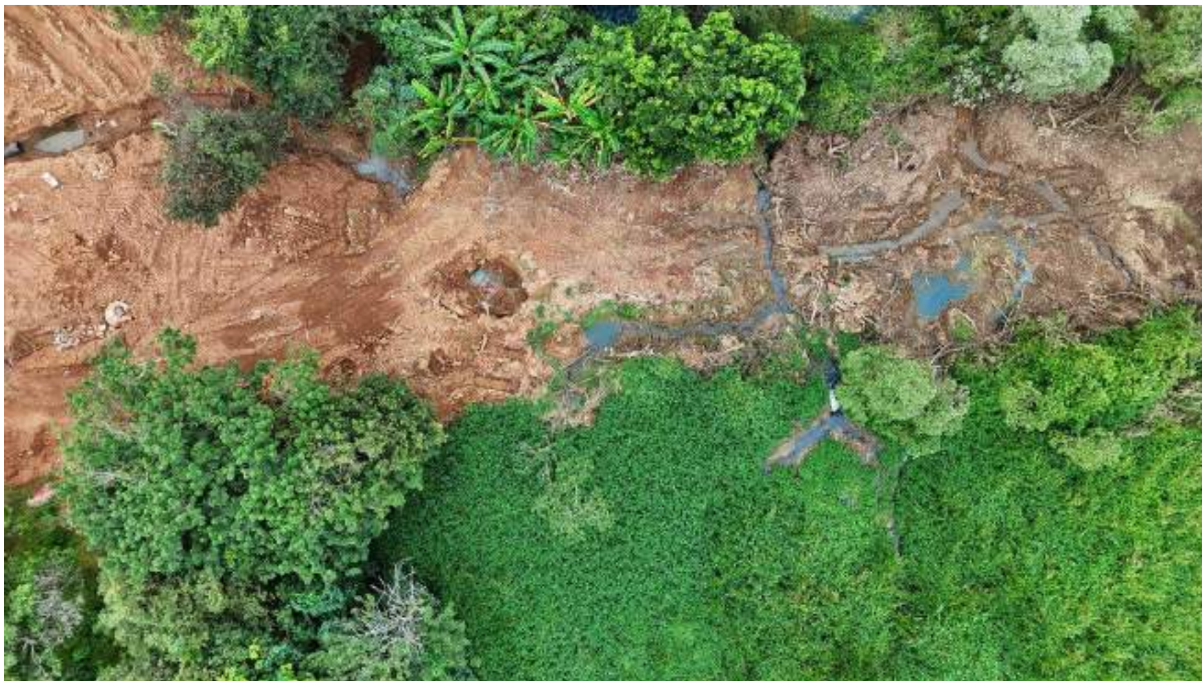
Foto 10 — Vista aérea ampliada — visualização completa da extensão do corredor de intervenção e dos pontos críticos de avaria do emissário existente.
