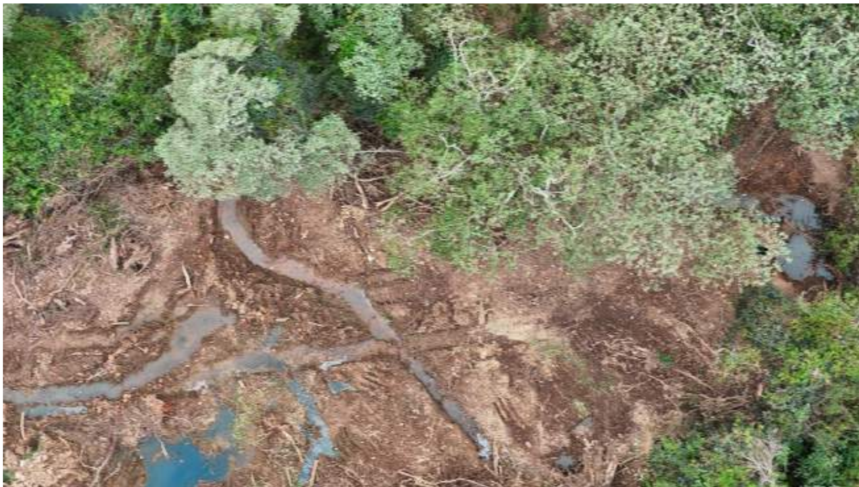
Foto 19 — Vista complementar do trecho — registro adicional das condições do emissário existente para documentação do estado de degradação.
