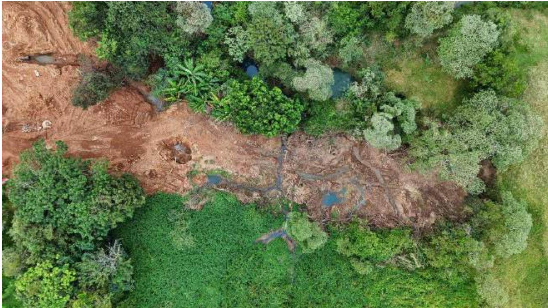
Foto 01 — Vista aérea geral do trecho — identificação do emissário existente com avarias e pontos de extravasamento de esgoto ao longo do leito.
