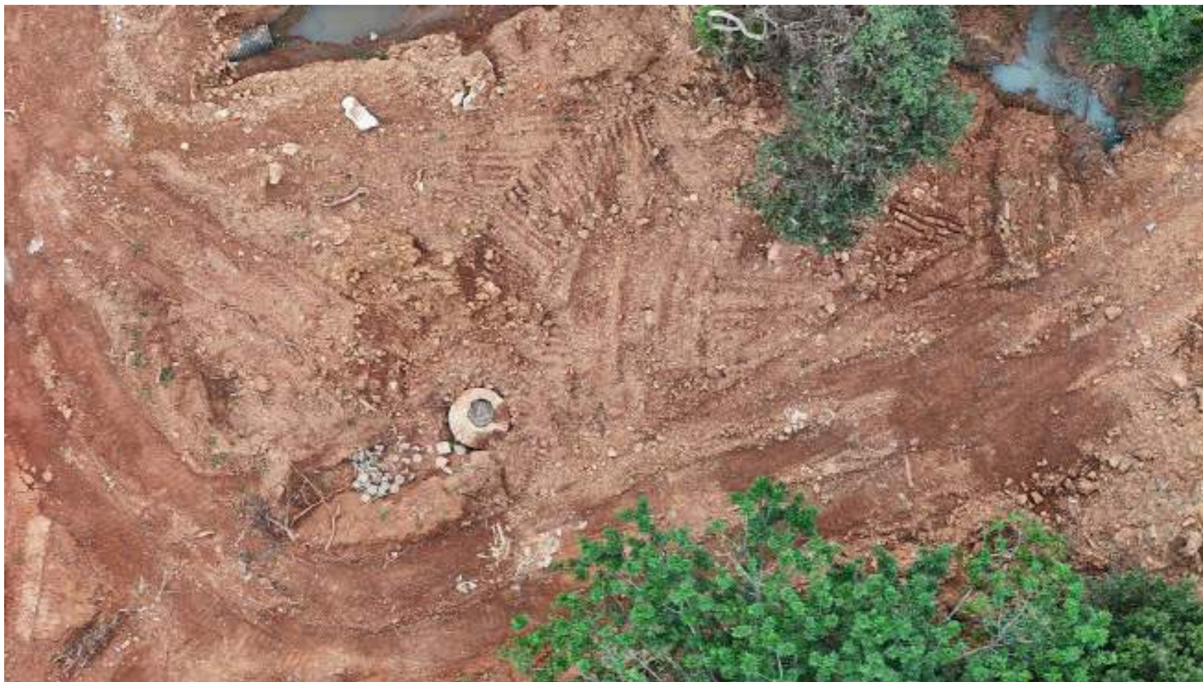
Foto 16 — Vista do trecho extremo — extravasamentos de esgoto identificados na terminação do emissário, confirmando as avarias estruturais da tubulação.
